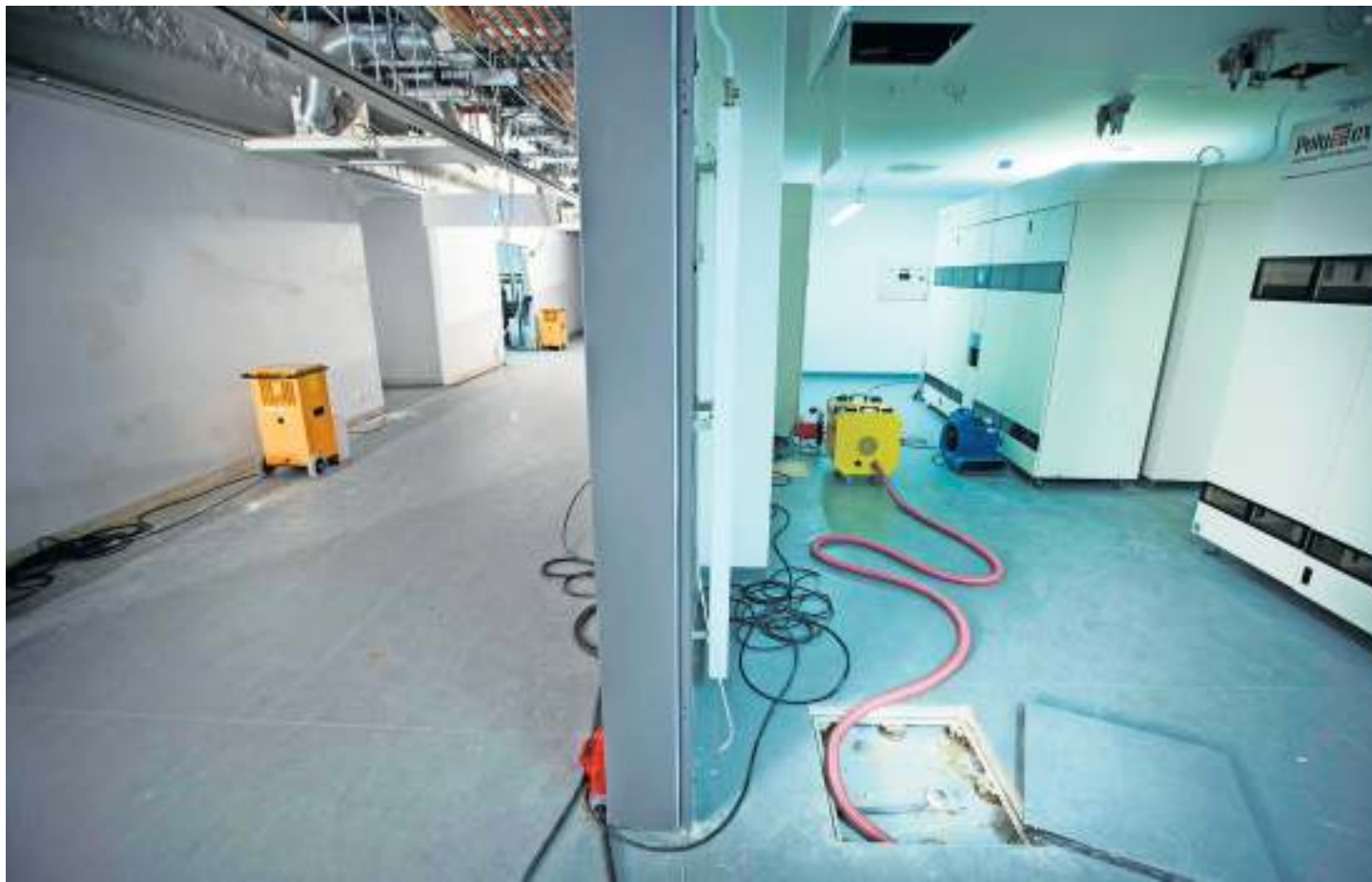
Die Räume sind mittlerweile getrocknet. Eine bange Frage lautet: Hat der Doppelboden im Keller Schaden genommen?
