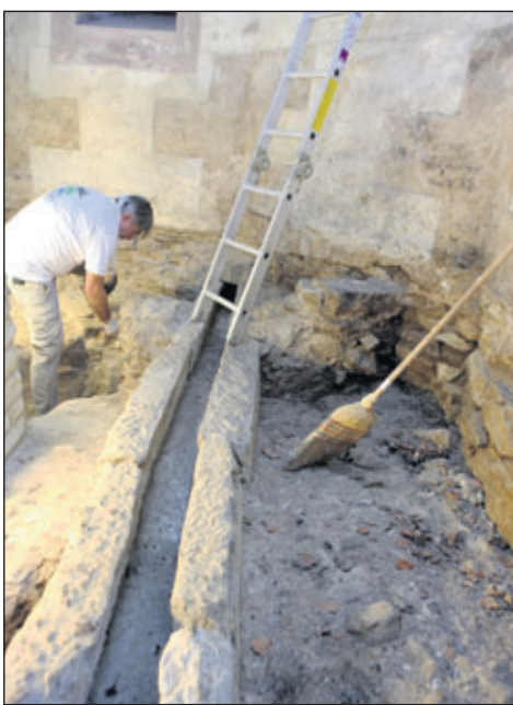
Reinhold Kießling putzt die Wasserrinne im Untergeschoss, die Quelle dazu ist längst versiegt.
